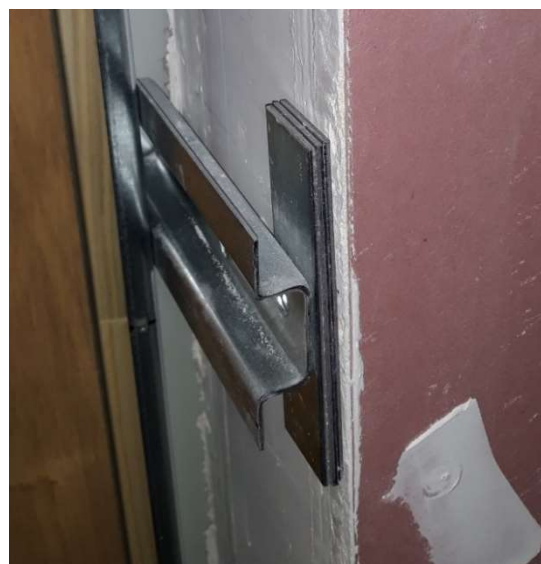
Nesprávná způsob podložení kotvicího profilu. Není vymezena mezera mezi stěnou a kotvicím profilem v místě polodrážky zárubně.
